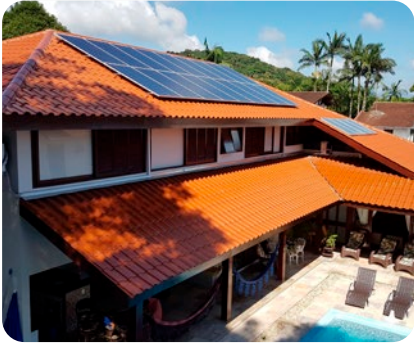
Gerador fotovoltaico residencial de 6,12 kWp - SC
