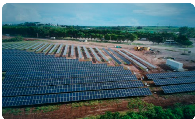
UFV RAÍZEN - 1.267,00 kWp
