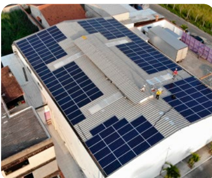
Gerador fotovoltaico industrial de 56 kWp - RJ
