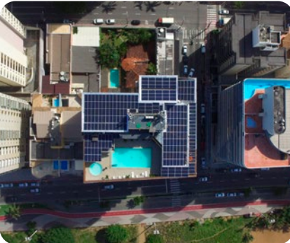
Gerador fotovoltaico em condomínio de 90 kWp - ES
