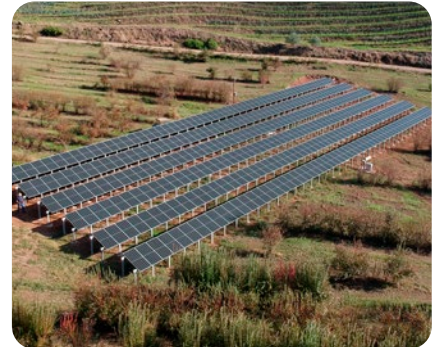
Gerador fotovoltaico para solo de 132 kWp - RS
