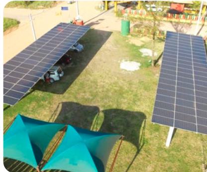
Gerador fotovoltaico para garagem de 40 kWp - ES
